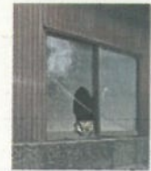
窓が割れた管理不全空家
