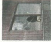
窓が割れた 管理不全空家
