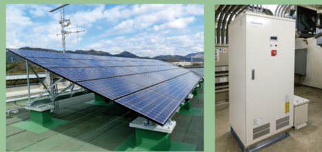
音羽庁舎に設置した太陽光発電システムと蓄電池
