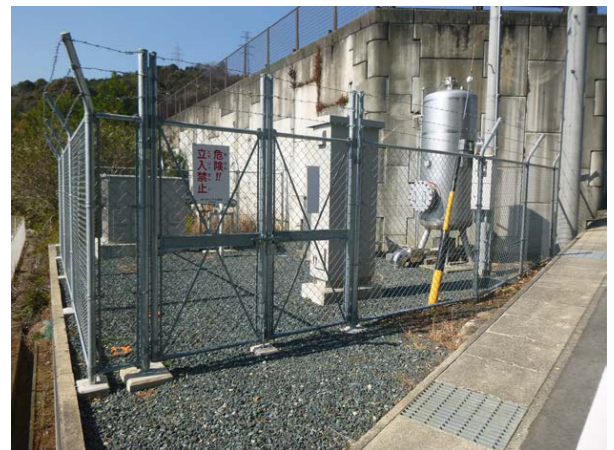
更新した手取ポンプ所
