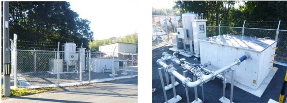
更新した上千両ポンプ所
