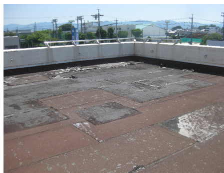
屋根の劣化状況（小坂井庁舎）
