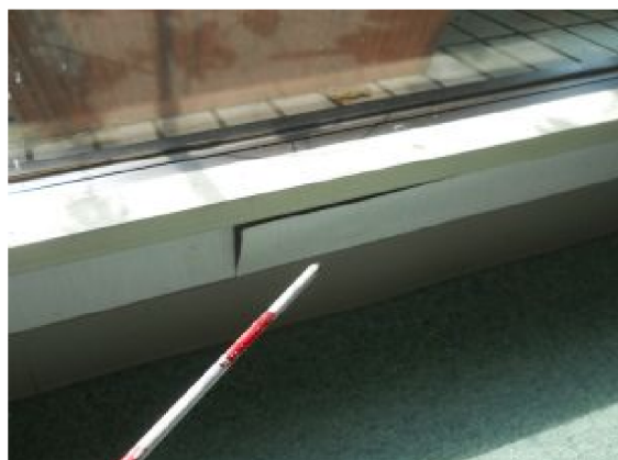
内装の劣化状況 (勤労福祉会館)
