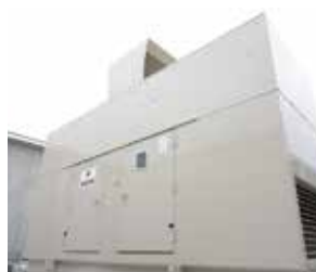
屋上に設置された自家発電機。約3日間分の電力を発電できます。
