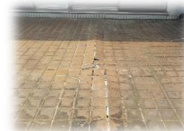
床タイルの割れ
