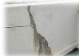
外壁のクラック
