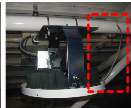
照明落下防止対策
