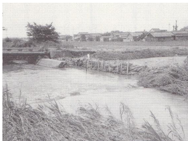
七夕豪雨による白川堤防の決壊（S49・7：市史より）
