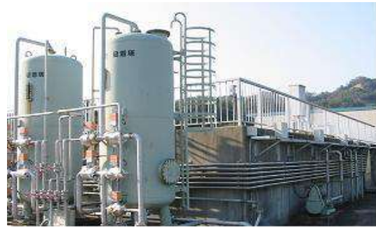
浸出水処理施設
