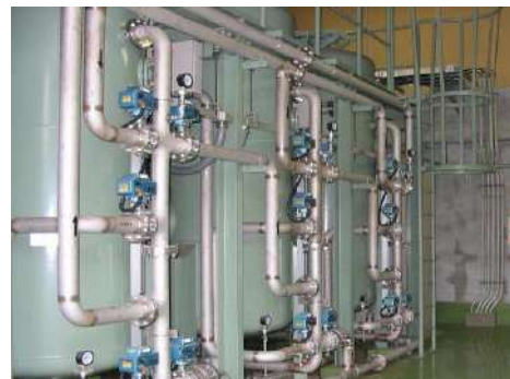
排水処理施設
