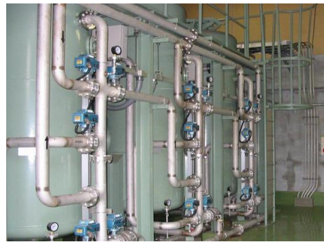
排水処理施設
