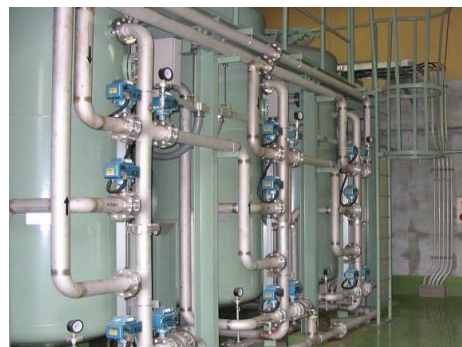
排水処理施設
