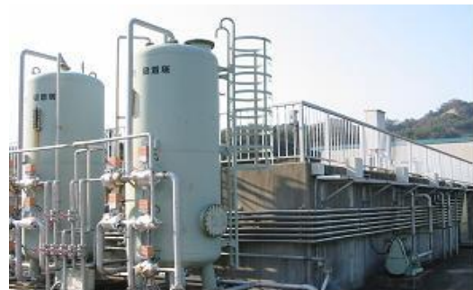
浸出水処理施設
