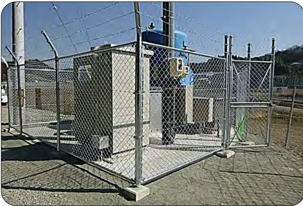
さいか 財賀ポンプ所（財賀町）
