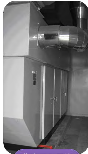
非常用発電機
