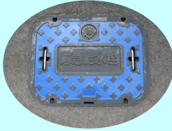
『応急給水栓筐』
