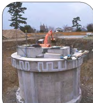
飲料水兼用耐震性貯水槽
