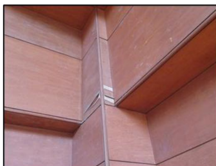
内装の劣化状況（御津体育館）
