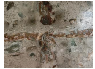
鉄筋の腐食度調査（腐食有）
