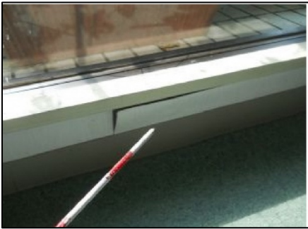
内装の劣化状況（勤労福祉会館）
