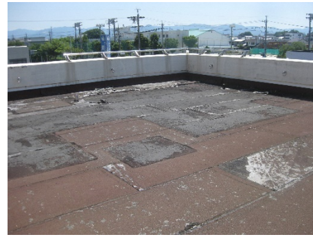
屋根の劣化状況
