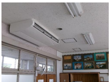
美術室や理科室・技術室等 特別教室のエアコン
