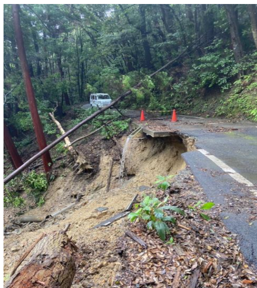
財賀町（林道被害・財賀線）
