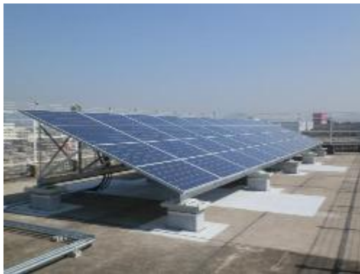
〔豊川市役所北庁舎屋上の太陽光発電システム〕
