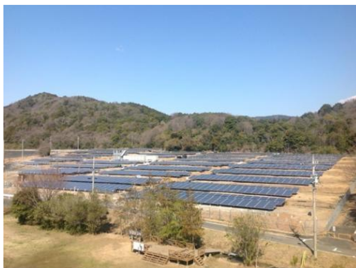
〔遊休地を活用した太陽光発電所〕
