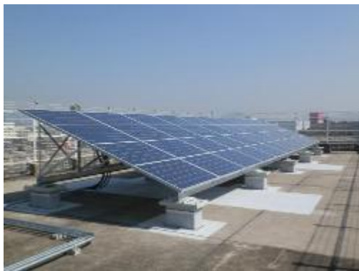
【豊川市役所屋上の太陽光発電システム】 発電容量：10kW 平成 25 年 3 月設置
