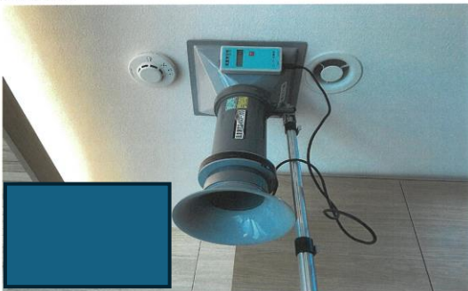
(換気システム)
