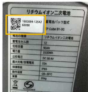
蓄電池銘板写真
