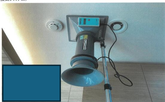
(換気システム)
