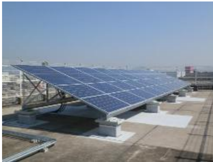
〔豊川市役所北庁舎屋上の太陽光発電システム〕
