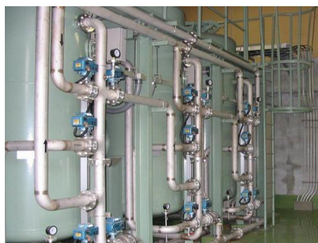
排水処理施設
