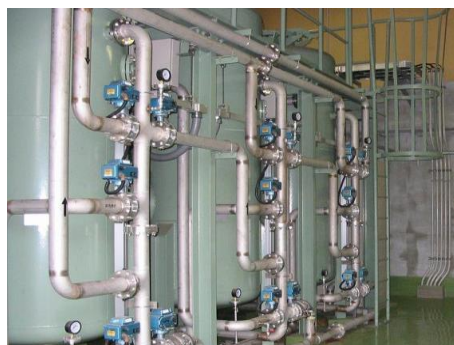
排水処理施設
