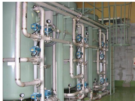
排水処理施設
