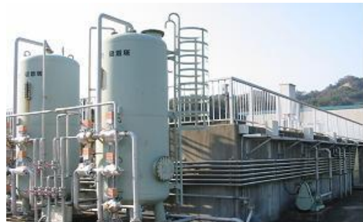
浸出水処理施設
