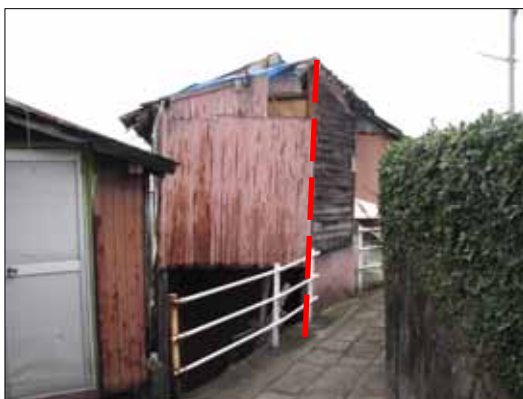
一部の柱が傾斜している例
