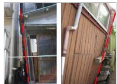
ハ：柱の変形が著しく崩壊の危険がある例
