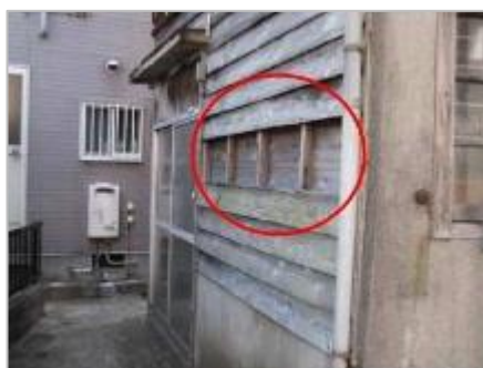
イ：外壁の仕上げ材の一部がはがれ、下地が露出している例（15点）
