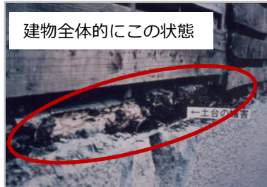
ロ：全体的に土台が蟻害により失われている例
