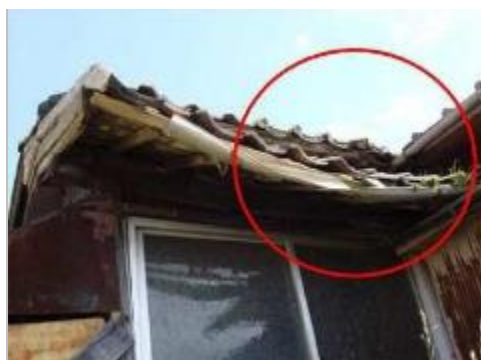
ロ：軒の裏板、垂木等が腐朽し、軒が垂れ下がっている例（25点）
