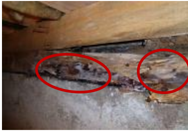
イ：局部的に土台が蟻害により失われている例
