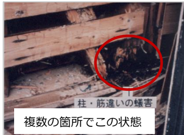
ロ：柱、筋かい端部等の複数箇所で蟻害・腐食・破損等がみられる例
