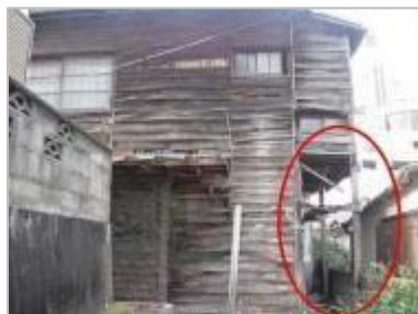
ロ：柱の数箇所に破損があり傾斜している例
