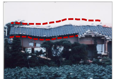
ハ：建築物全体の变形が著しく、軒先の線・棟の線が歪んでいる例
