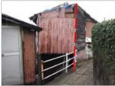
イ：一部の柱が傾斜している例
