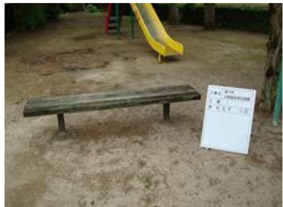
座板の劣化がみられるベンチ
