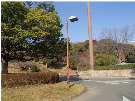
再塗装が必要な照明柱
