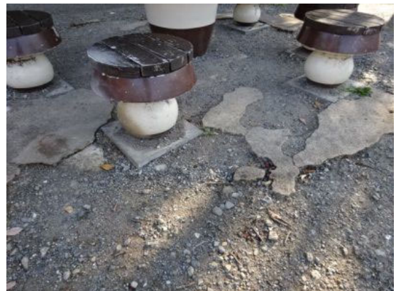
休憩施設付近の舗装の剥がれ
