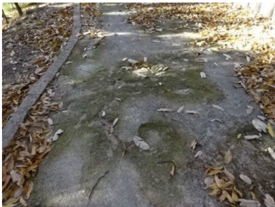
ひび割れしている園路
