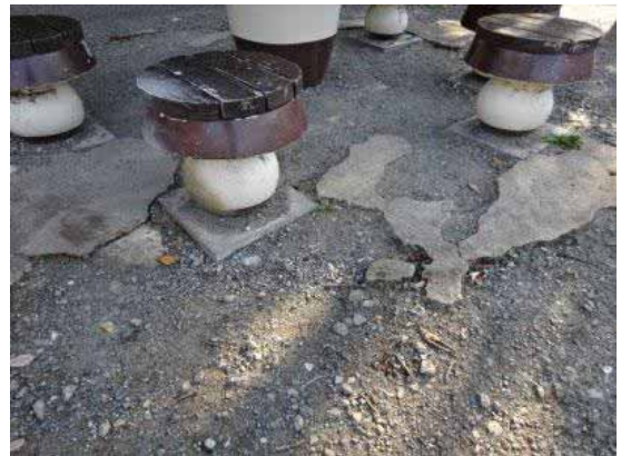
休憩施設付近の舗装の剥がれ
