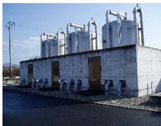
除鉄・マンガン処理設備（三上水源浄水場）
