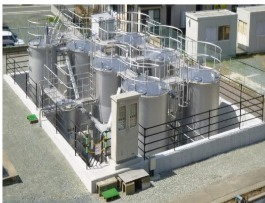
急速ろ過設備（一宮浄水場）
