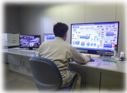
中央監視装置による監視
