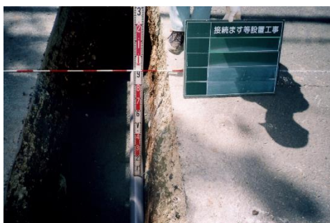
管横に 10cm 保護砂入っていない
