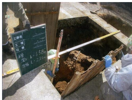
矢板のみの設置で、腹起し、サポートがない
