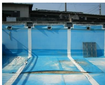
写真1 錆や劣化が進行したプール
