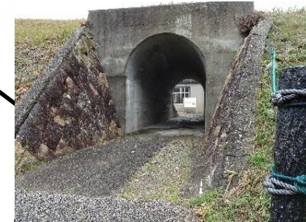
旧第三信管置場へ通じるトンネル ※一部、舗装の劣化により、通行しにくいところがあります。
