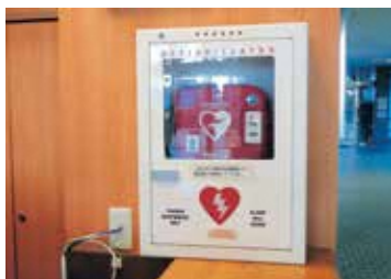
市役所受付に設置してあるAED
