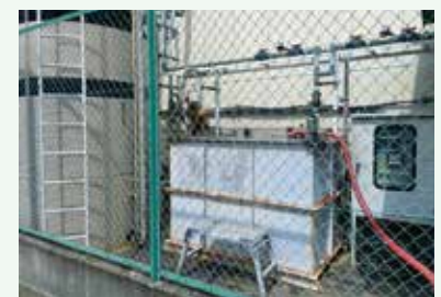
工場等に設置されている除害施設
