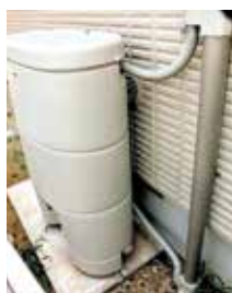
雨水貯留タンク
