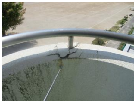
屋外の劣化状況（牛久保小学校）
