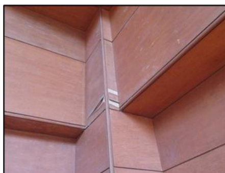
内装の劣化状況 (御津体育館)
