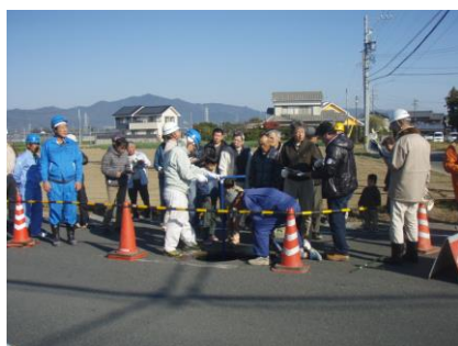
応急給水施設（接続点）
