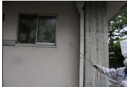
壁モルタル浮き
