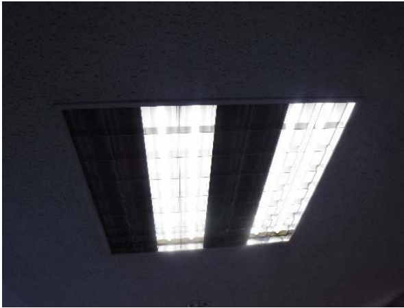
省エネのため蛍光管が外された照明器具
