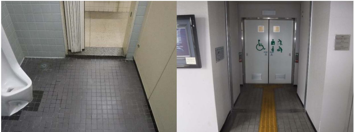
段差の解消が出来ていないトイレ出入口
