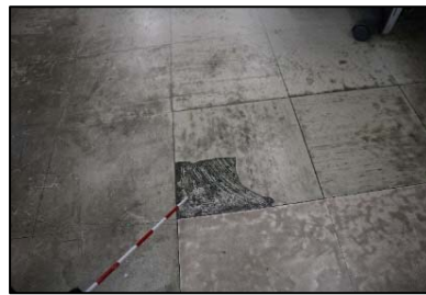
床Pタイル剥離
