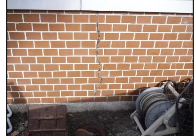
壁タイルクラック
