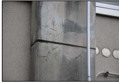
柱コンクリート膨れ
