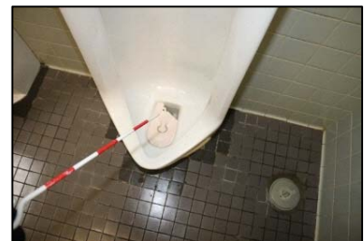
衛生器具割れ
