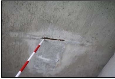
天井鉄筋露出
