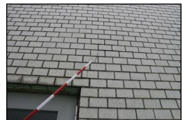
壁タイルクラック ※
