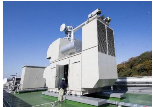
非常用発電設備(愛媛県庁)
