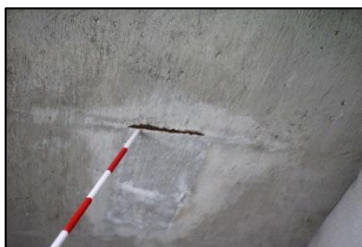
天井鉄筋露出
