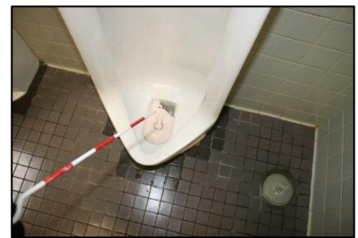
衛生器具割れ
