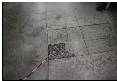
床Pタイル剥離
