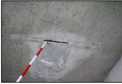
天井鉄筋露出
