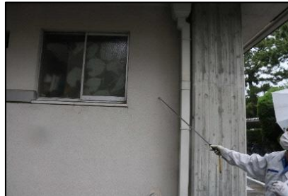
壁モルタル浮き
