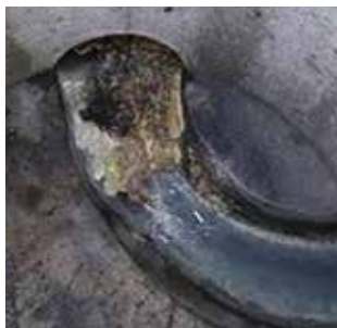
油で詰まった下水道管
