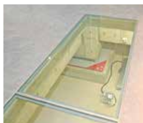
地下に配置された免震装置。防災センター1階の見学窓から見る事ができます。
