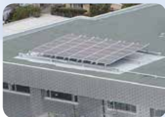
屋上に設置された太陽光パネル
