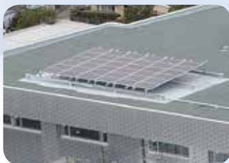
屋上に設置された太陽光パネル
