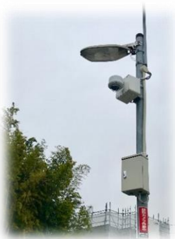
街頭防犯カメラ(設置例)
