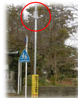
防犯カメラ(設置例)
