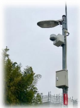
街頭防犯カメラ(設置例)
